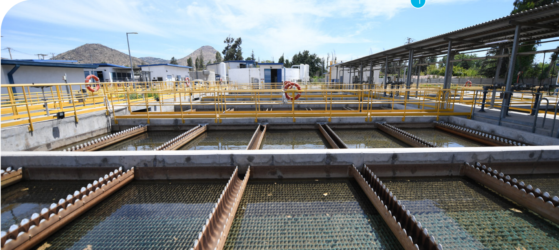
7 Planta de Agua Potable Chamisero, Colina
