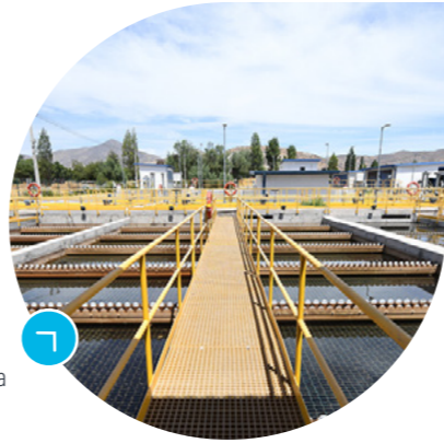
Planta de Agua Potable Chamisero, Colina
